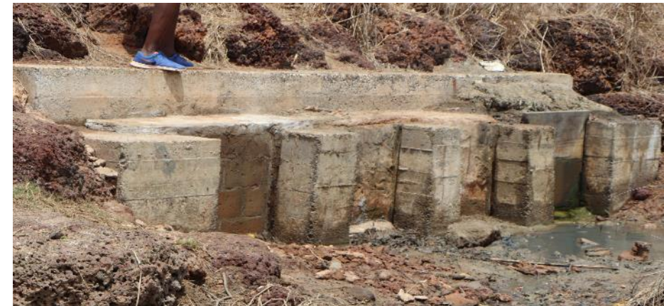
Dégradation des valves, Dorse, Biombo
